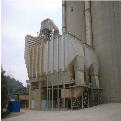
Aspecto exterior de um electrofiltro
