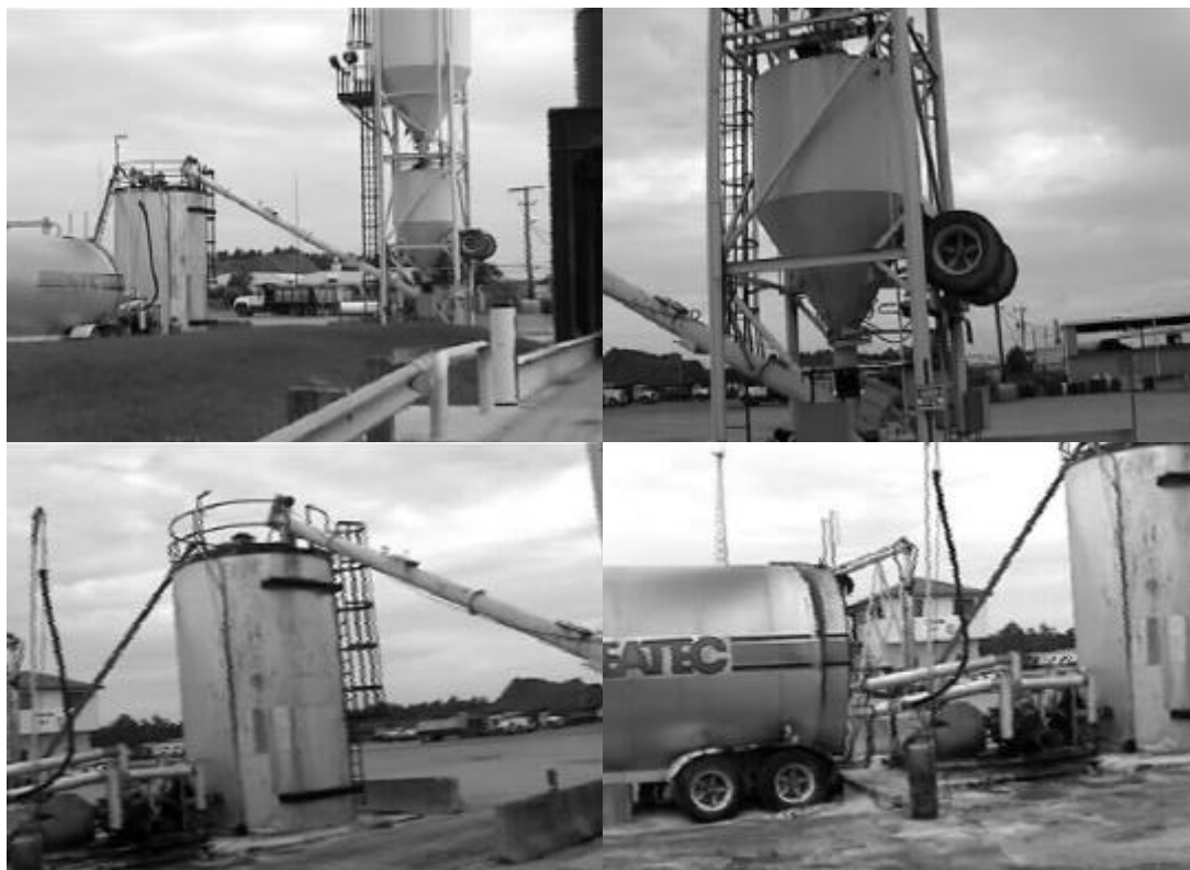
FIGURA 3.11 – Exemplo de usina de asfalto-borracha no Estado da Flórida
