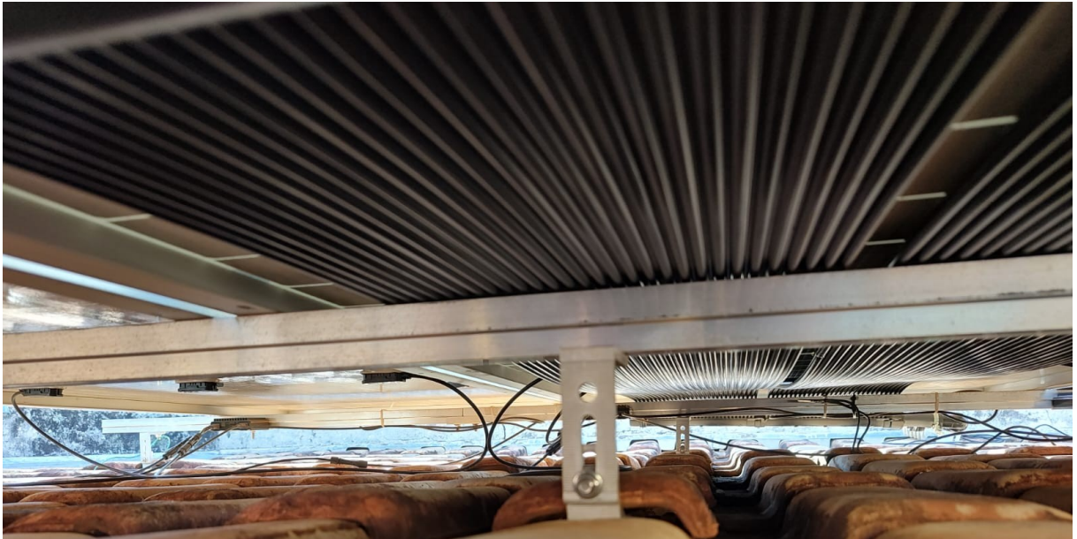
Figura 12: Serpentina montada sob o painel.
