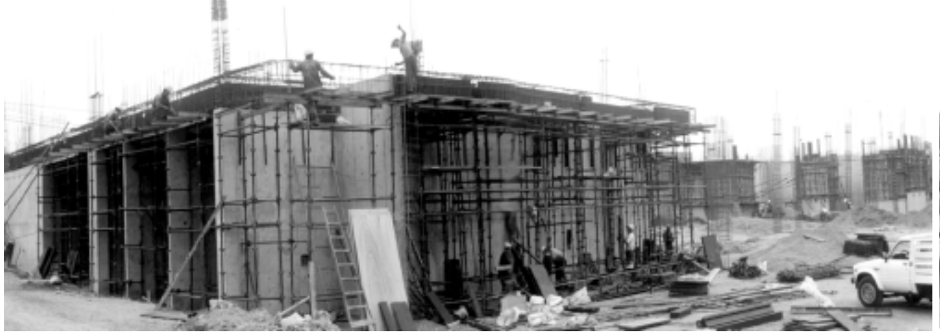
Modernas técnicas de construcción se vienen aplicando en los trabajos, por parte de la experimentada constructora Remanso SAC.
