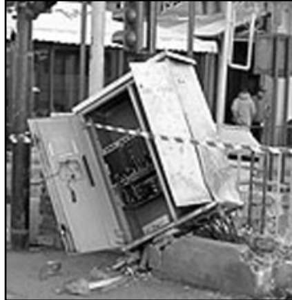
Qui sopra, la cabina di ghisa devastata dall'esplosione di una delle due bombe a Sturla
