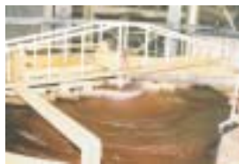
Instalasi fosfatasi floatasi
