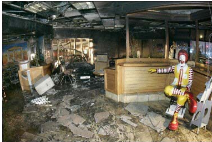
(MacDo incendié à Corbeil-Essonnes)
