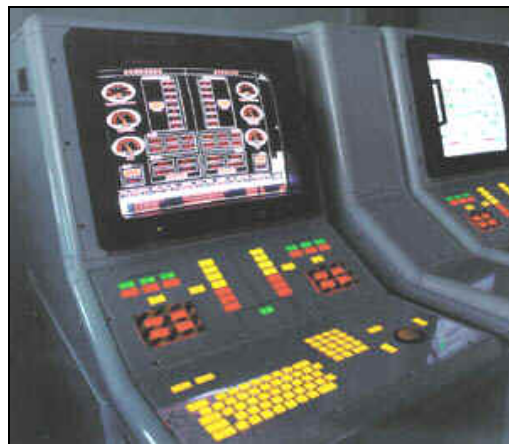
Figura 43 – Sistema de Controle da Propulsão
