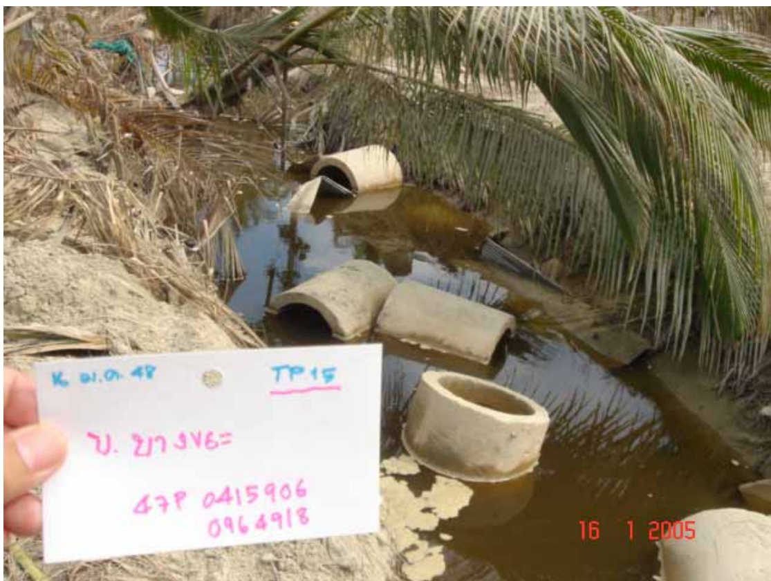
ภาพที่ 29 ท่อระบายน้ำที่บ้านบางขะ
