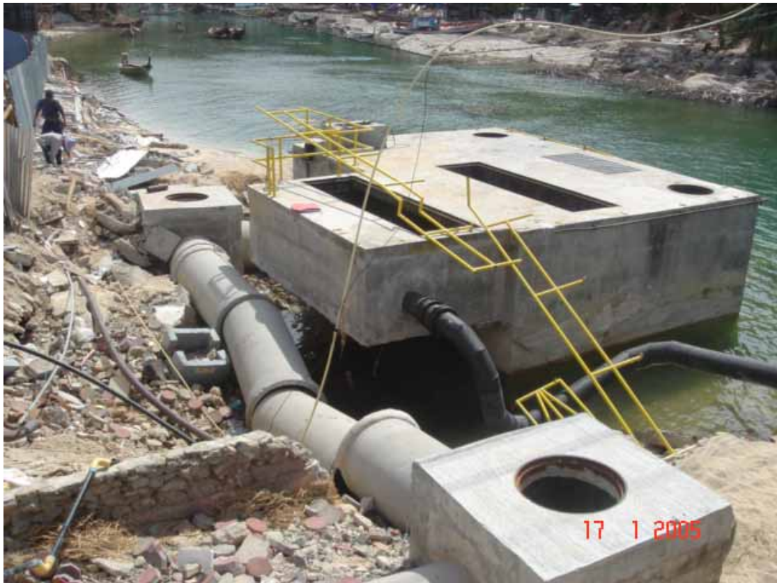
ภาพที่ 28 ท่อระบายน้ำและระบบบำบัดน้ำที่ป่าตอง
