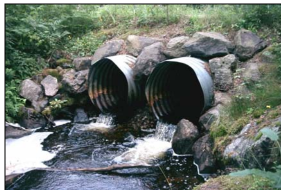
Foto 7.3.1. Vandringshinder 4. Dubbla vägtrummor med mindre fall i utlopp. Fallhöjd ca 0,3 m. Inv. sträcka 10, 02-07-18.
