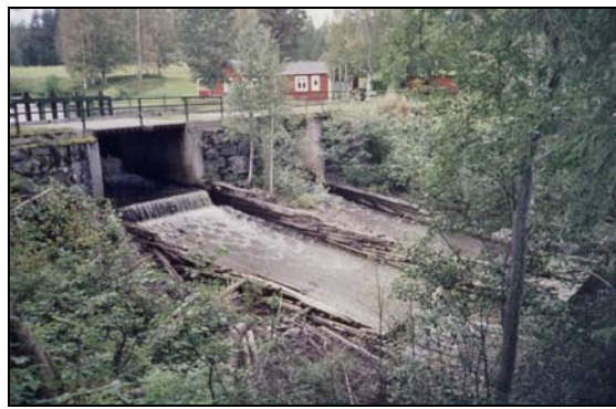
Foto 7.1.7. Vandringshinder 5. Masugnsdammen. Fallhöjd ca 7 m. Inv. sträcka 38, 00-09-07.
