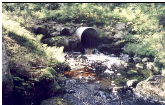
Foto 6.3.5. Vandringshinder 8. För högt satt vägtrumma vid vägen mot Tortjärnen. Fallhöjd i utlopp ca 0,3 m. Inv. sträcka 13, 00-08-29.
