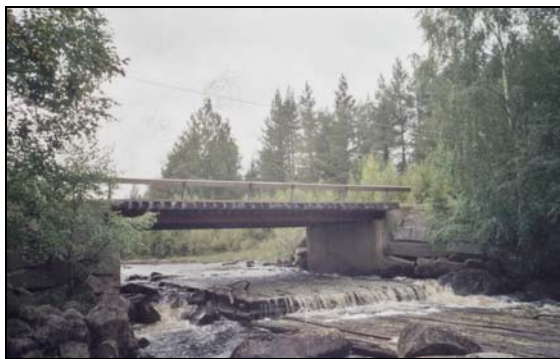
Foto 7.1.3. Vandringshinder 2. Skibord av trä under bro. Inv. sträcka 23, 00-09-06.
