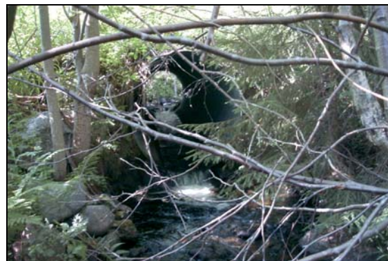
Foto 6.4.3. Vandringshinder 2. Vägtrumma vid vägen norr om Stor-Trösken. Inv. sträcka 1, 02-07-18.
