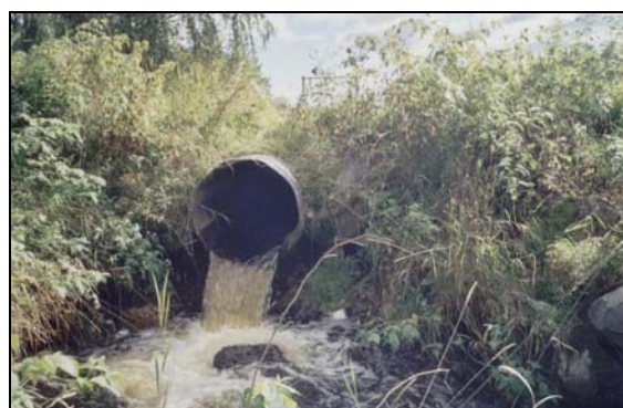
Foto 6.6.1. Vandringshinder 1. För högt satt vägtrumma, fallhöjd i utlopp ca 0,7 m. Inv. sträcka 4, 00-09-04.
