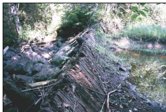
Foto 8.1.4. Vandringshinder 4. Dubbla vägtrummor med mindre fall i utlopp. Fallhöjd ca 0,3 m. Inv. sträcka 10, 02-07-18.
