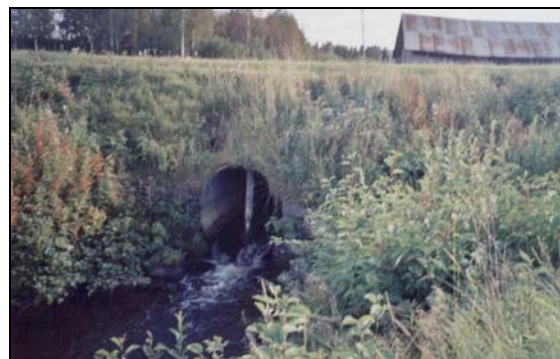
Foto 6.5.2. Vandringshinder 8. För högt satt vägtrumma vid Grönviksvägen. Fallhöjd i utlopp ca 0,2 m.. Inv. sträcka 6, 00-09-12.
