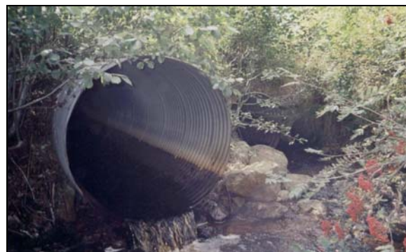
Foto 6.3.6. Vandringshinder 13. För högt satt vägtrumma vid vägen mot Lingbo. Fallhöjd i utlopp ca 0,2 m. Inv. sträcka 13, 00-08-29.
