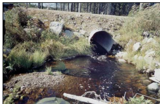
Foto 6.3.3. Vandringshinder 3. För högt satt vägtrumma, fallhöjd i utlopp ca 0,1 m. Inv. sträcka 5, 00-08-28.
