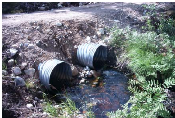
Foto 6.4.5. Vandringshinder 4. Dubbel vägtrumma vid nyanlagd skogsväg. Inv. sträcka 19, 02-07-18.
