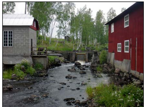
Foto 7.2.5. Vandringshinder 8. Mindre betongdamm. Fallhöjd ca 1,5 m. Inv. sträcka 49, 02-07-09.
