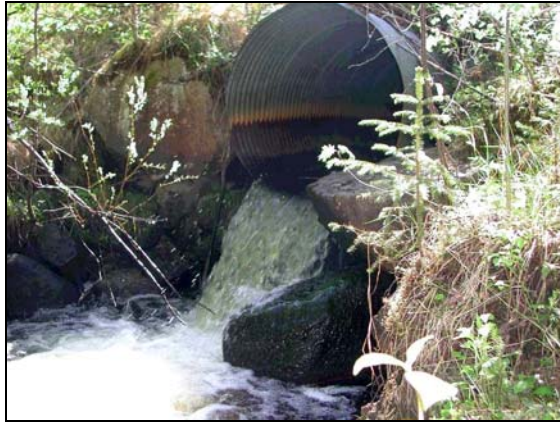
Foto 1. Vandringshinder 1. Vägtrumma under Massenvägen, fallhöjd vid utlopp 0,7 m, 2002-08-19.
