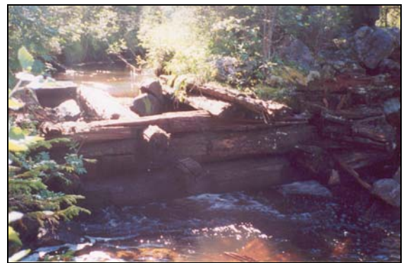
Foto 4. Vandringshinder 4. Rest av flottningsdamm med underfall, 2002-08-19.
