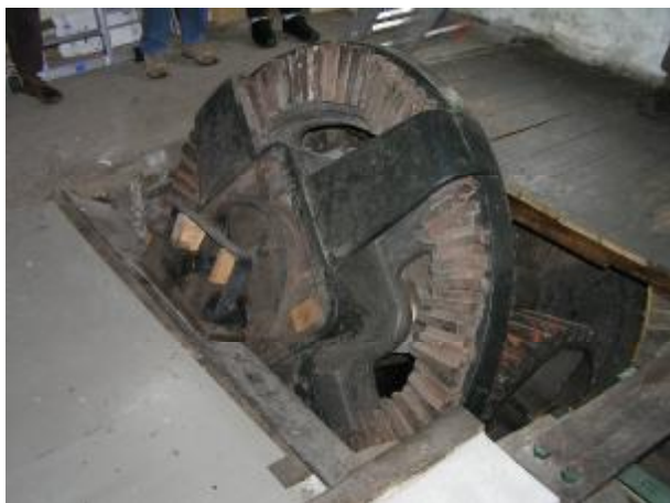
Dezelfde vijzel met een deel van het aandrijfwerk gezien binnen het gemaal
