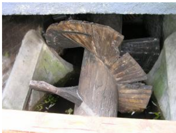
De vijzel van nabij gezien aan de buitenzijde van het gemaal
