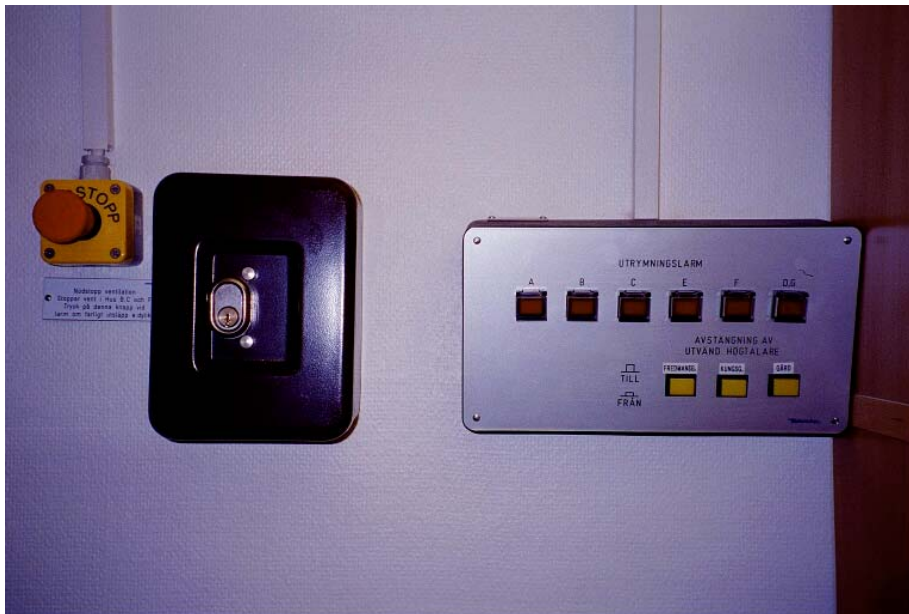
Bild 3, tryckknappar för utrymningslarm
