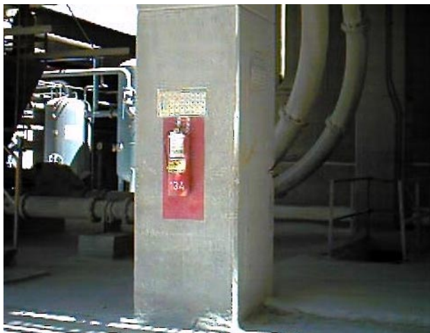
Matafuegos en la planta
