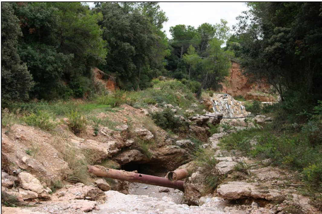
↑ Vista de la riera de Can Dalmases. S'aprecia la presència d'elements que han quedat descalçats a causa de l'excavació de la llera a major profunditat a causa d'avingudes recents.
