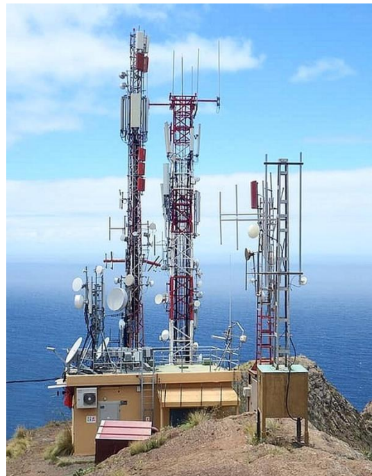
Figura 5.19a. Diferentes tipos de antenas emisoras y receptoras en un centro de telecomunicaciones.
