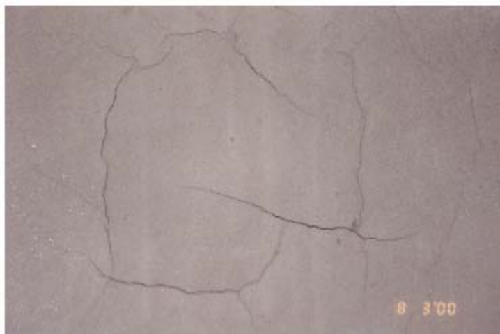
Figura II-7 - Revestimento apresentando fissuração mapeada típica de retração da argamassa, devido ao emprego de alto teor de cimento (CASAREK et al, 2005).
