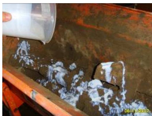
Figura 2.3 - Mistura de látex não diluído à argamassa. O polímero não se misturou adequadamente na massa, concentrando-se em alguns pontos.
