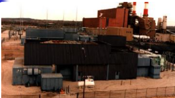
โรงไฟฟ้าและสถานีย่อย
