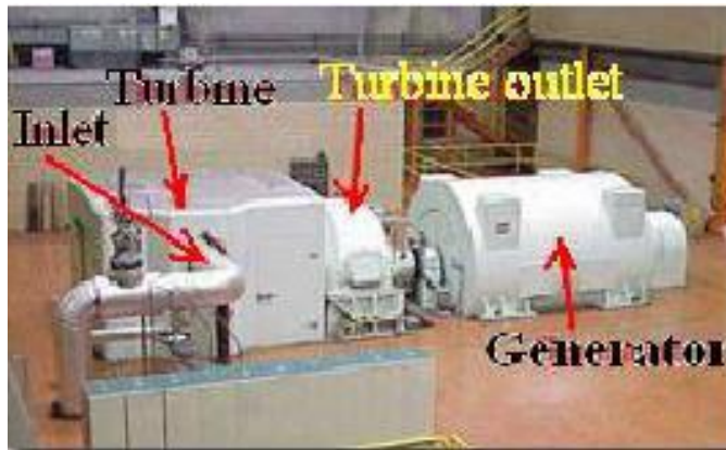
โรงไฟฟ้าและสถานีย่อย
