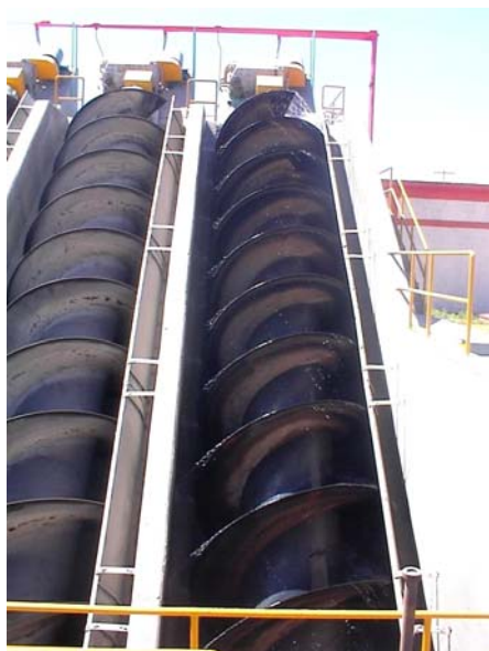
Figura 3: Bombeo de aguas residuales a la primera etapa de tratamiento por bombas tipo tornillo, con el modelo de Arquímedes.
