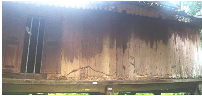
Gambar 2 Dinding kayu yang reput, kering dan pecah akibat kelembapan dan serangan perusak
