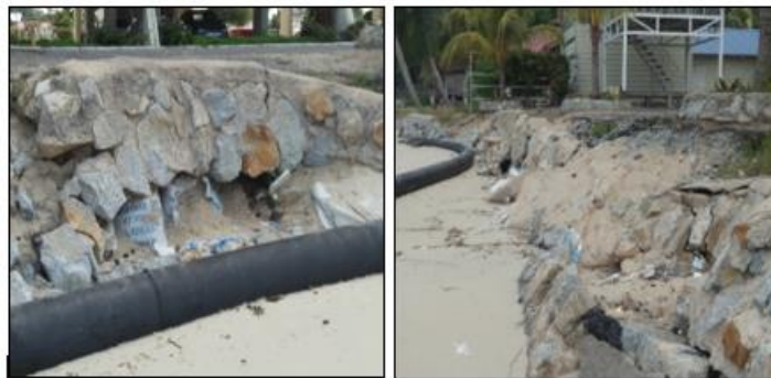
Rajah 3. Kerosakkan paip BMS dan groin di Pantai Batu 5, Port Dickson
