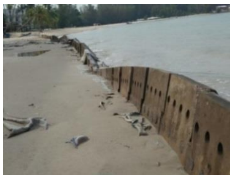
Rajah 2. Tembok penghalang hakisan yang mendap di Pantai Batu 5, Port Dickson
