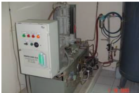
Foto No. 3.8.3 Compresor de oxígeno
